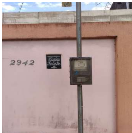
Numero de identificação e relógio de energia
